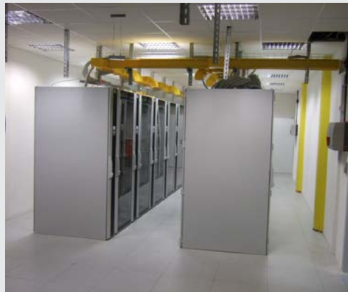
erweiterte Rechnerräume am Standort Kamenz
